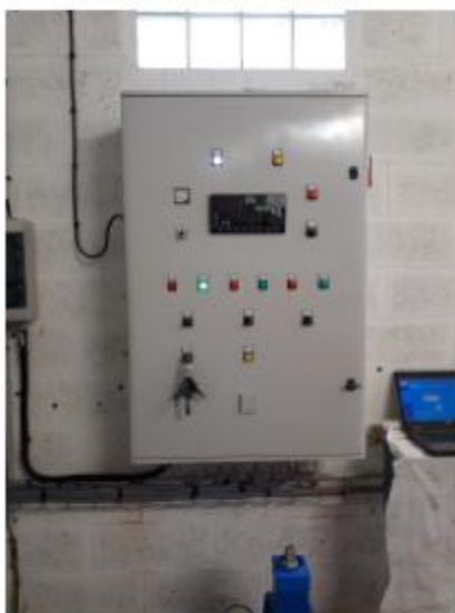
Armoire de Commande
